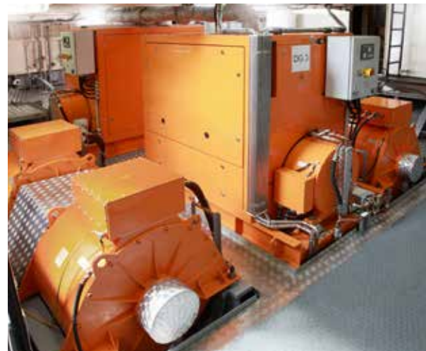
Torque-Schiffsantriebe, Dieselstrom- aggregat-Generator-Kombination und VP600 Umrichter.
